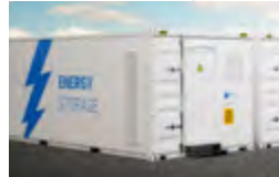
Batteriespeicher „Kairos“, Belgien Standort: Ruien, Belgien Kapazität: 25 MW Inbetriebnahme: geplant Jan. 2023
